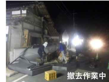
八代鏡宇土線（八代市） 倒壊建築物
