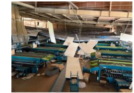
J A 熊本経済連 第二園芸集送センターの損壊（宇城市）
