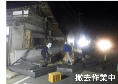
八代鏡宇土線（八代市） 倒壊建築物
