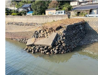
防波堤空石積崩落 （合串漁港）
