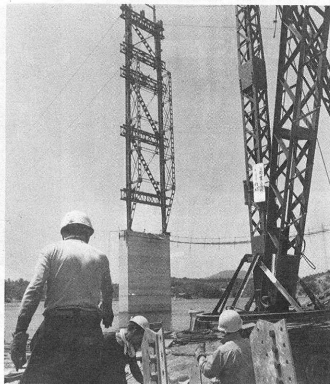
架橋工事は正確な技術と安全作業で着々と進められた
