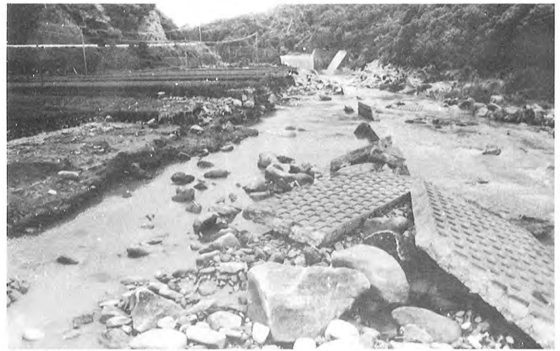
川の中流に押し流された砂防ダム擁壁(松島町)
