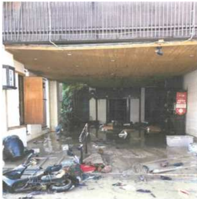
「一富士旅館」(人吉市)の被災状況
