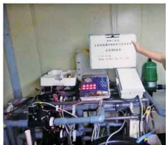
設備の導入（液肥混入機）
