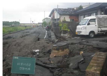
地震で被災した下水管渠（益城町）
