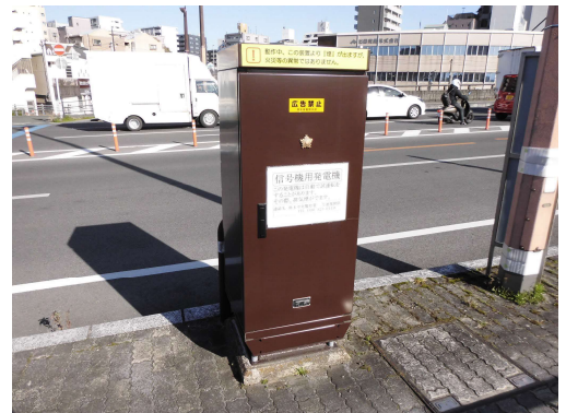
令和 5 年度（2023 年度）設置：信号機電源付加装置
