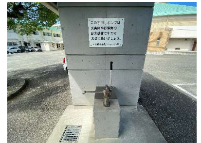
防災井戸の写真（菊池市道の駅）
