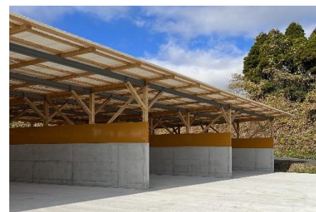
堆肥化処理施設
