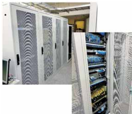
増強されたセンター設備
