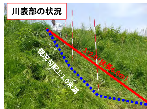
写真 2.1-12 堤防法面の状況 堤防本来の形状が確保できていない
