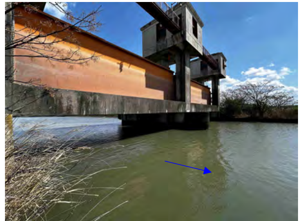
写真 2.3-34 浜戸川との合流部潤川水門
