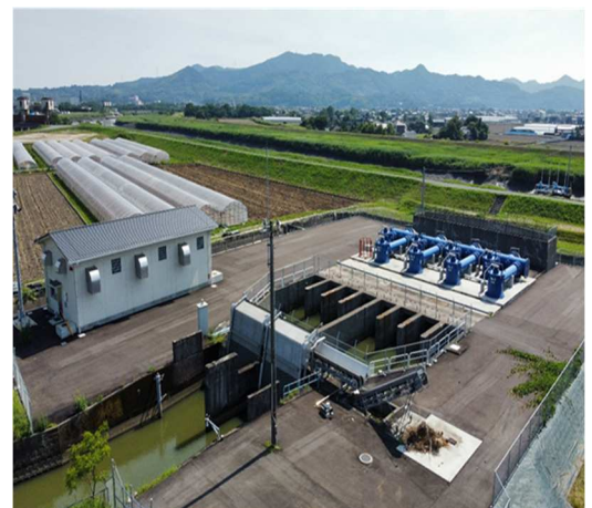
碓江排水機場（熊本市）
