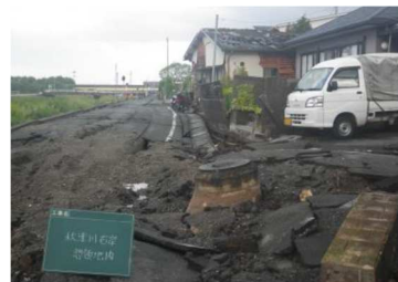
地震で被災した下水管渠（益城町）
