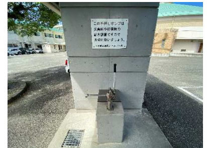
防災井戸の写真（菊池市道の駅）
