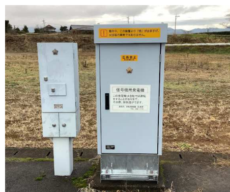
令和 4 年度設置：信号機電源付加装置
