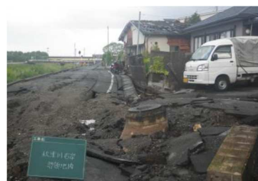
地震で被災した下水管渠（益城町）
