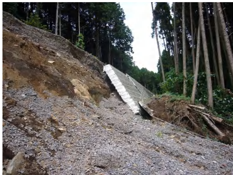
写真. 崩壊地頂部の林道路肩の破損状況(図中①)
