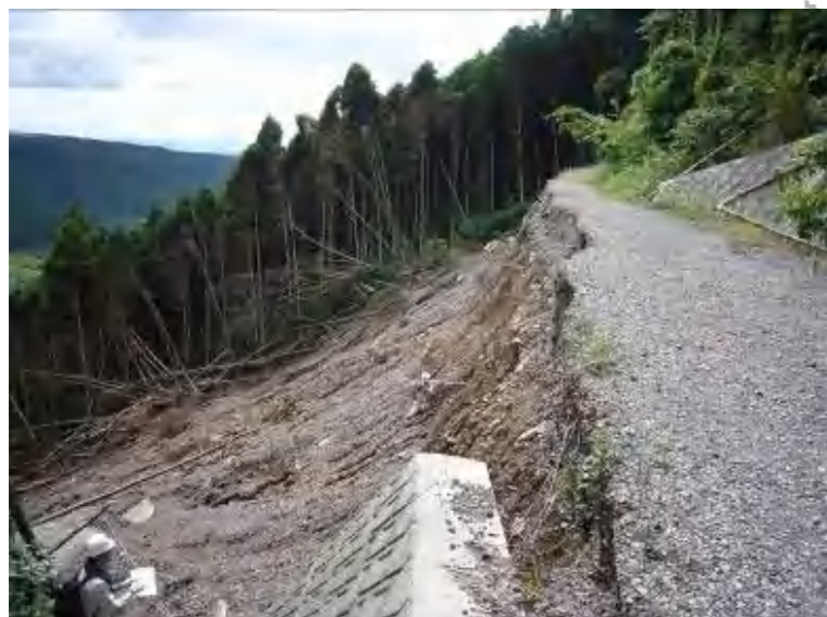
写真. 崩壊地頂部の状況
