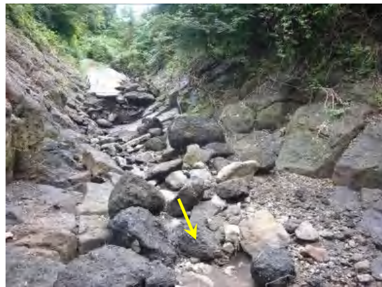
写真. 土石流最上部における洗掘状況(图中①)
