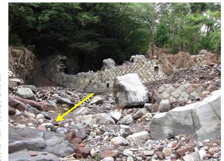
写真. 既往対策施設の破損状況
