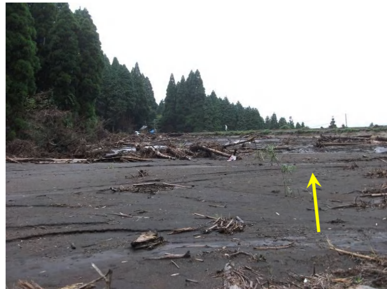
写真. 鉄道盛土上部の土砂堆積状況
