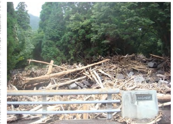
写真. 道路橋の閉塞状況
