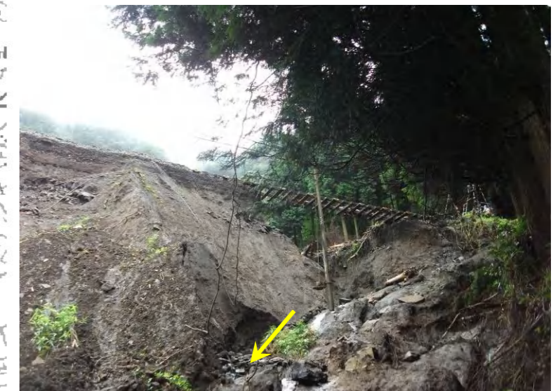
写真. 鉄道の被害状況
