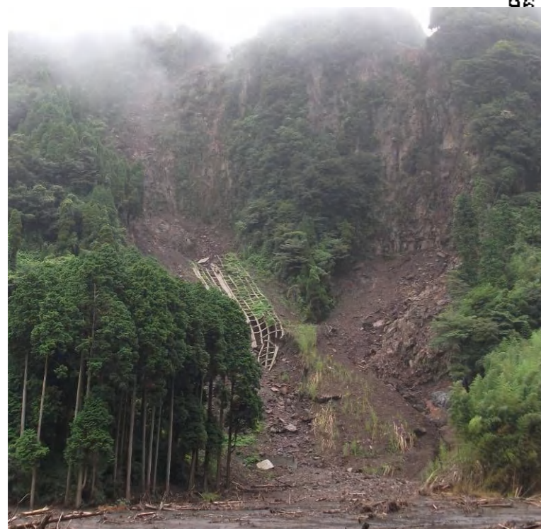
写真. 既設法枠工周辺部の崩壊状況
