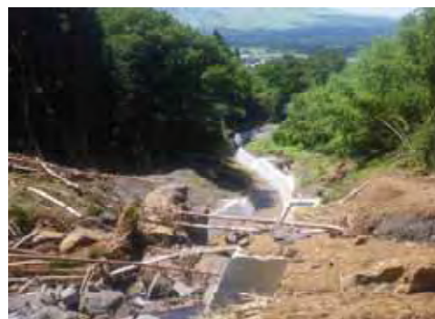
写真 3.17 八反田川砂防堰堤の流木捕捉箇所の下流域の状況
