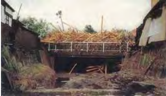
写真 3.21 国道57号松原橋の河道閉塞状況(平成2年災害後)
