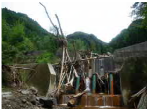
写真 3.12 塩井川砂防堰堤の流木捕捉状況
