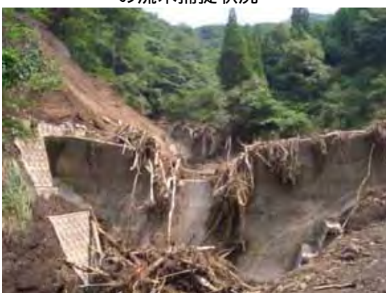
写真 3.10 東岳川本流における治山谷止工の土砂・流木捕捉状況
