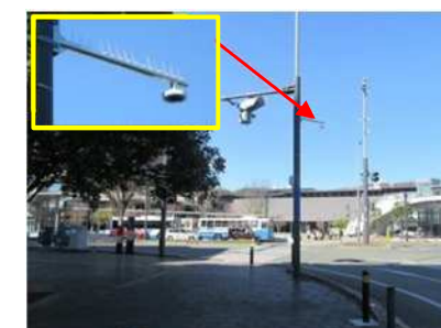
熊本駅周辺に増設した防犯カメラ
