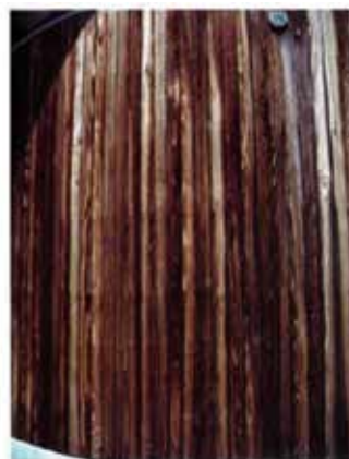
写真1 木製外壁の灰色化 右側は日当たりや雨掛りが多く灰色化している。なお、灰色化した後でも真鍮の色やデザインとマッチするよう設計すれば、灰色化の悪影響を持たせることも可能である。
