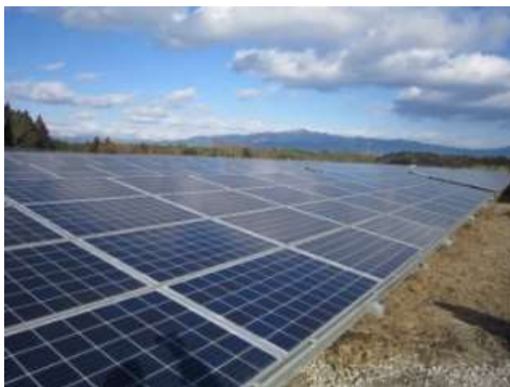
大規模な地上設置型太陽光発電施設
