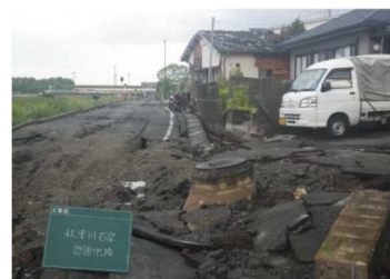
地震で被災した下水管渠（益城町）
