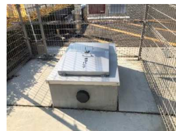
防災井戸の写真（菊池市 道の駅）
