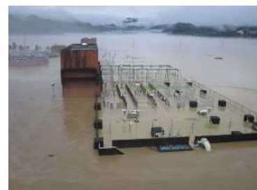
浸水した下水処理場（人吉市）
