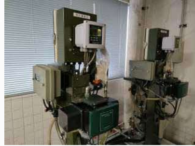
原水濁度計 (左)
