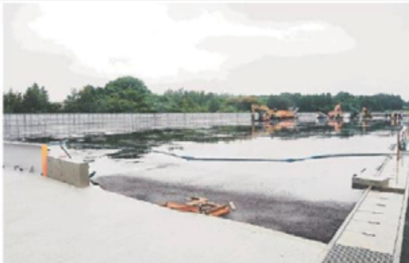
熊本地震で被災した住宅の解体がれきを集積・処理するため、県が整備した「2次仮置き場」 =29日、益城町(久保田尚之)
