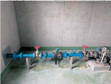
地下水ポンプ（新川北浄水場）
