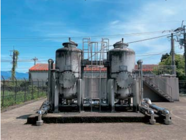
急速ろ過機（新川北浄水場）
