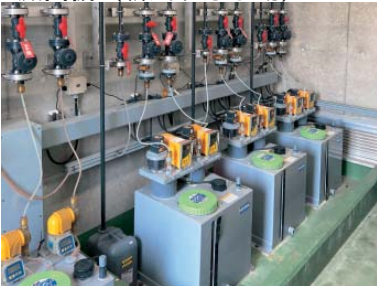
滅菌機（新川北浄水場）
