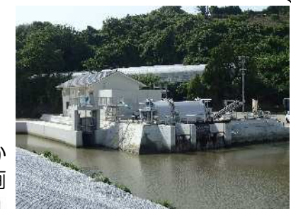
農業生産基盤整備(大口西部排水機場)
