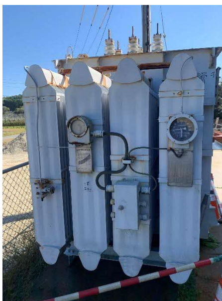
(保管物品の一例) ポリ塩化ビフェニル（PCB）を含有する変圧器
