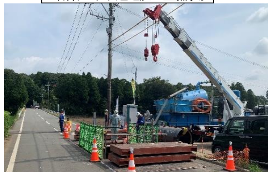
管渠の下水道施設の整備状況
