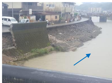
被災状況（令和2年7月時点）
