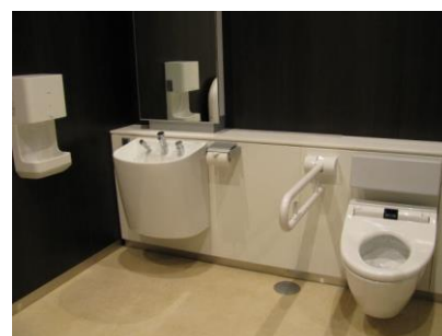
車いす・オストメイト対応トイレ (右) 車いす対応 (左) オストメイト対応
