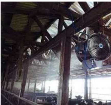
細霧換気扇 (岡山県)
