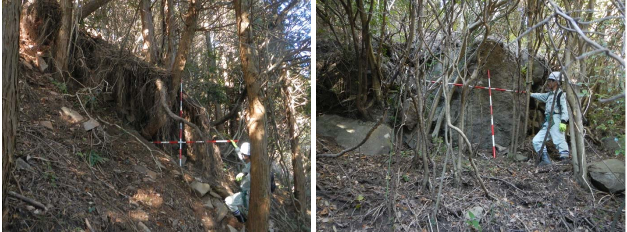
写真 2.1 モニタリング亀裂 S-3 周辺のはらみだしの状況
