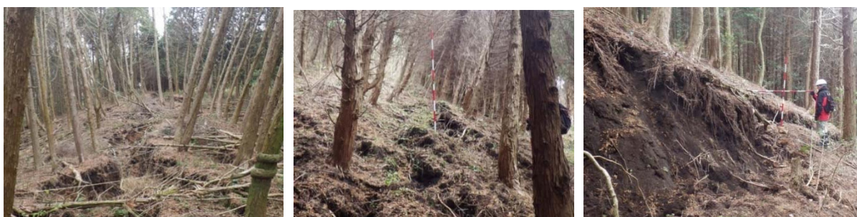
写真 1.1 幅広尾根の亀裂（左：尾根部陥没帯、中：緩斜面部山落ち亀裂、右：遷急線下部谷落ち亀裂）
