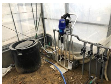
写真1 液肥用タンク・液肥混入器・電磁弁
