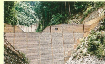
谷止工 森林に流れる渓流の、 渓岸・渓床の浸食を防ぎ、 山脚の固定及び土砂の流出の抑止・調整を図ります。
