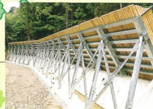
落石防止工 山の斜面に設置した防護施設や落石防止保安林の働きにより、 斜面上部からの落石を止めます。
