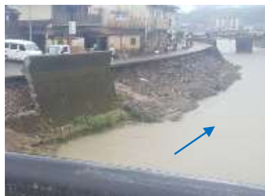
被災状況（令和2年7月時点）
