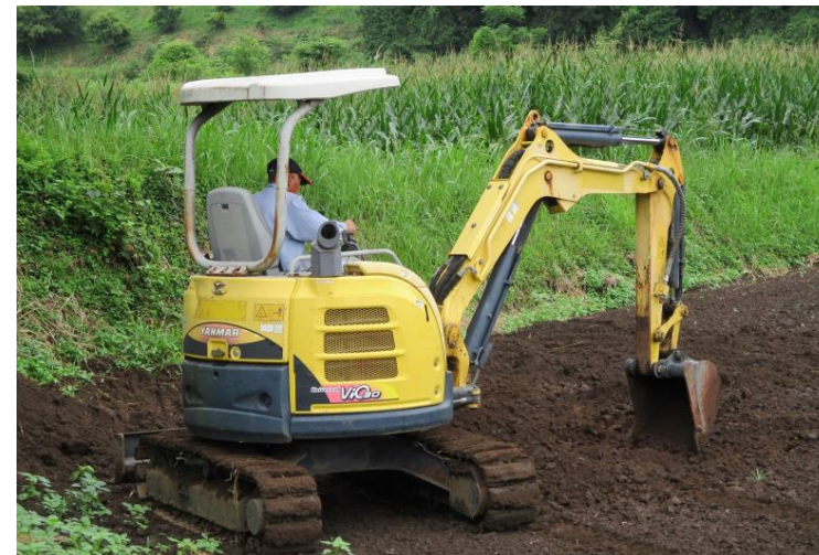
畦畔の除去や耕作放棄地の整備等に活躍中のバックホー
