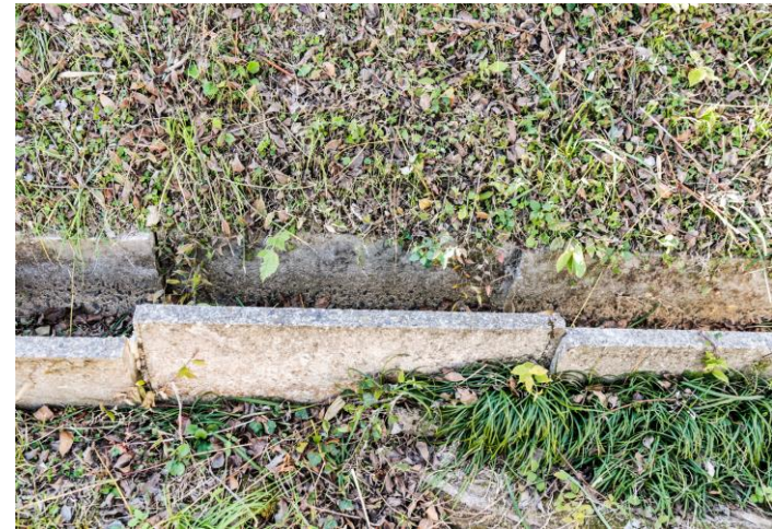
老朽化が進んだ旧水路
