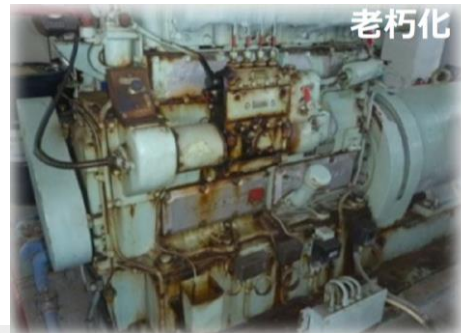
ポンプ設備の老朽化
