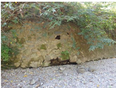
写真 2.6 巡視で確認された護岸欠損箇所
