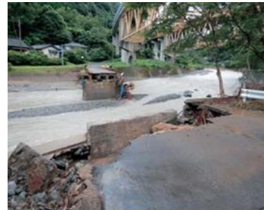
令和 2 年 7 月豪雨による万江川の 足算瀬橋流出状況（山江村万江）
