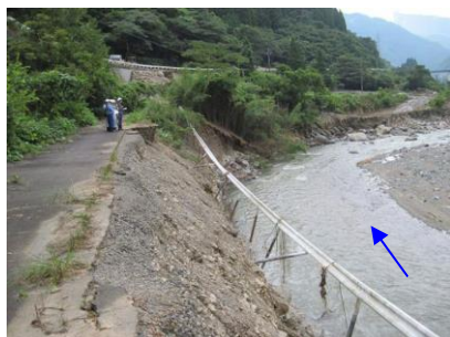
平成 24 年 7 月洪水による旧県道宮原五木線の 被災状況 (五木村 元井谷地区)
