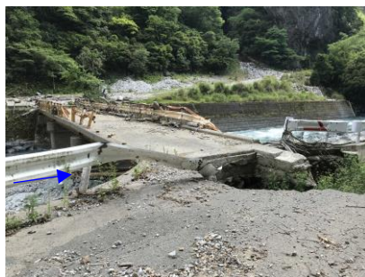
写真 2.2 梶原川の土砂・流木による橋梁の被害状況（令和2年7月豪雨）
