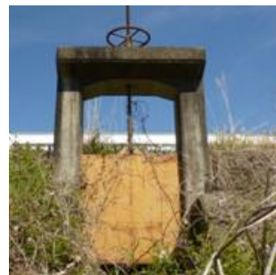
写真 2.7 老朽化した樋管
