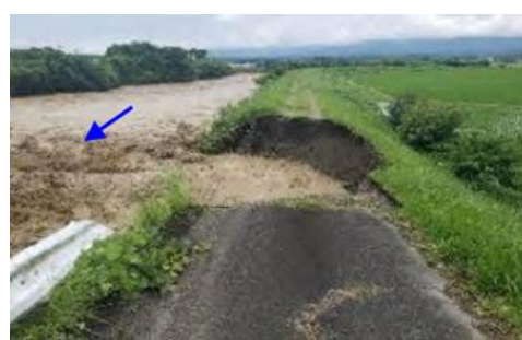
令和 2 年 7 月豪雨による免田川の堤防欠損状況
