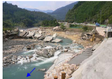
平成 18 年 7 月洪水による竹の川発電所 取水堰の被災状況 (五木村 竹の川地区)
