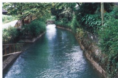
幸野溝 (世界かんがい施設遺産) (出典：八代河川国道事務所)
