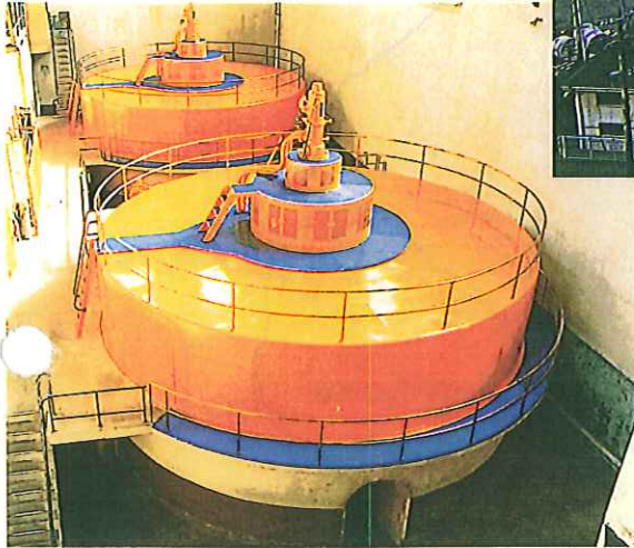
藤本発電所発電機
