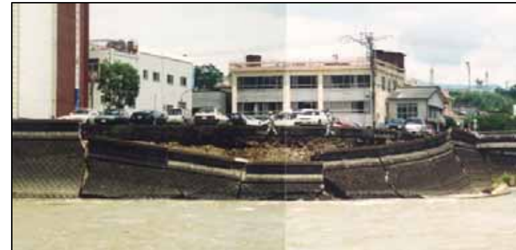
基礎洗掘により護岸が崩壊した球磨川の事例 (山田川合流点(H8.7.3~8の出水後)) 軟岩の人吉層が洗掘された場合でも同様の 崩壊が発生する可能性がある。
