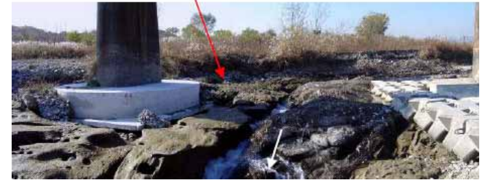
橋脚基礎部が洗掘された多摩川水系 浅川の事例
