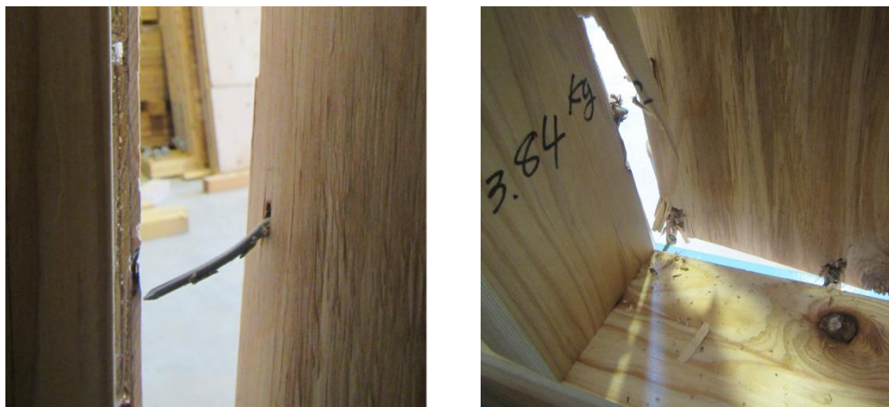
写真－7 枠組壁工法用耐力壁の破損状況
