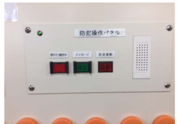
【パネルの放送連動は常時遮断】 ※全校放送が鳴らないように
