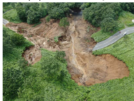
図 -2-(11) 小国町小国西部地区（農道崩壊）
