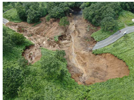
図 -2-(11) 小国町小国西部地区（農道崩壊）
