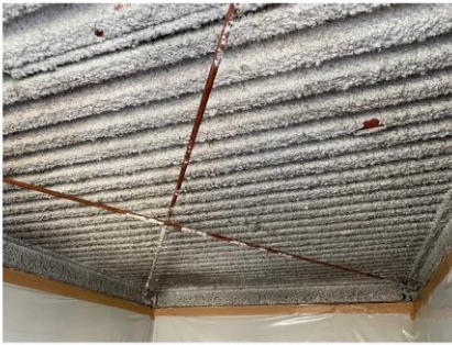
吹付け石綿(天井)
