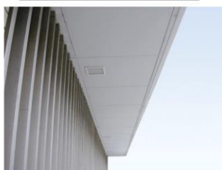
石綿含有けい酸カルシウム板 第1種(軒天)
