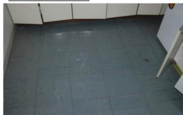
石綿含有ビニル床タイル
