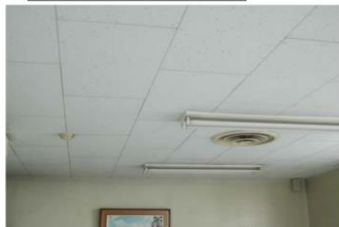
石綿含有ロックウール吸音天井板
