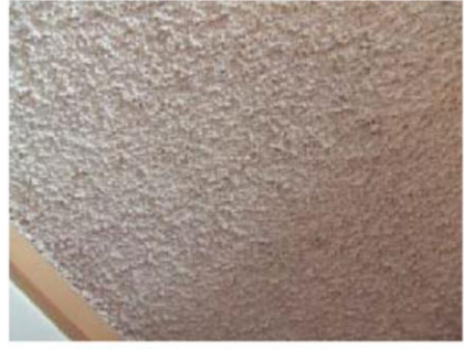
吹付け石綿(吹付けパーミキュライト)
