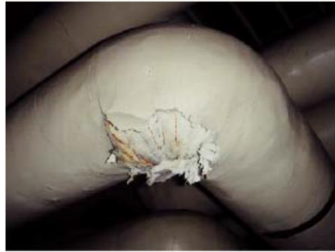
保温材(配管エルボー)
