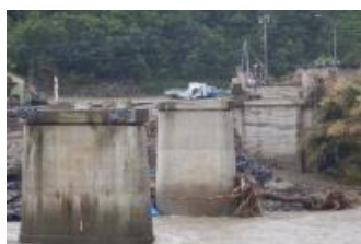
(国道219号 鎌瀬橋) 幹線道路の橋梁が流出
