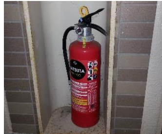
消火器の設置
