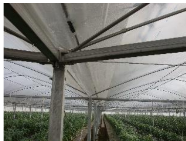
ハウスの内張り
