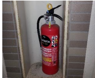
消火器の設置
