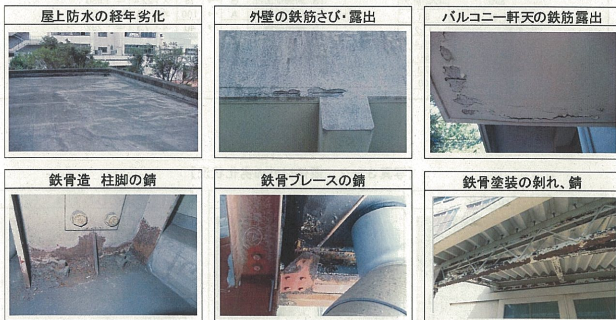
【写真3-1 躯体各部の代表的な劣化事象】
